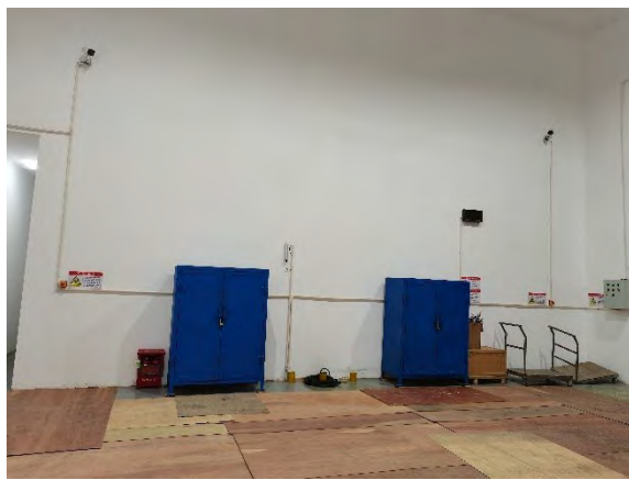
X 射线探伤室急停按钮照片
