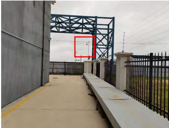
厂区边界监控设施
