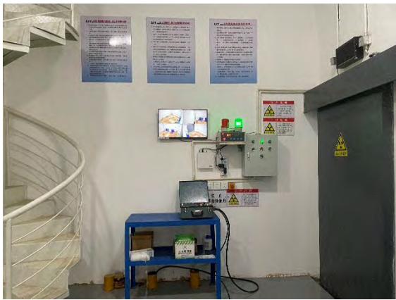
控制室 (X 射线探伤操作位)
