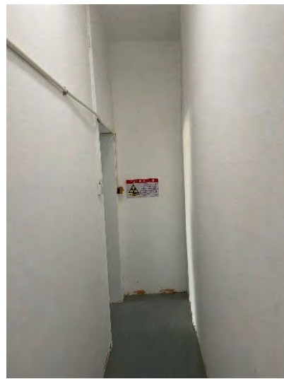
\gamma 射线探伤室急停按钮照片
