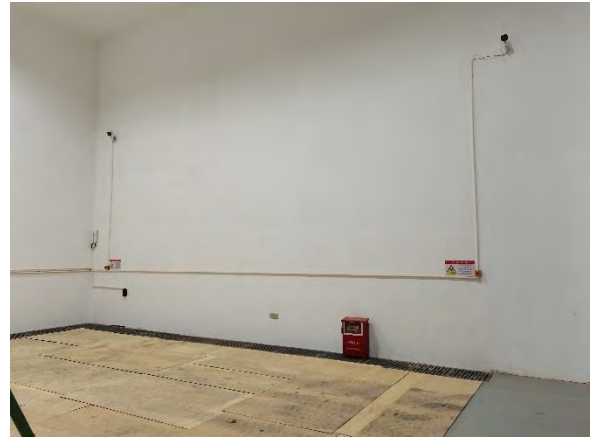
\gamma 射线探伤室急停按钮照片
