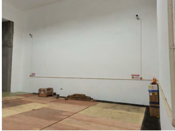
X 射线探伤室急停按钮照片
