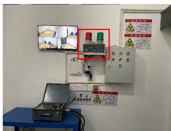
X 射线探伤室固定式辐射检测系统剂量率水平显示仪器
